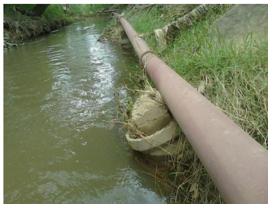
Foto 9 Rede coletora deslocada dos pilareteis devido a força da correnteza – arquivo pessoal janeiro/2014
