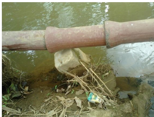
Foto 10 - Rede coletora deslocada dos pilareteis devido a força da correnteza – arquivo pessoal janeiro/2014
