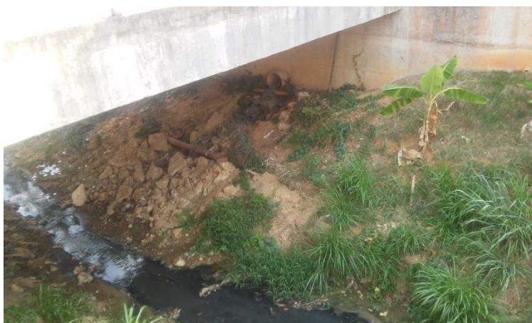
Foto 4 – Tubulação soterrada nas margens do rio – arquivo pessoal 07/10/2016
