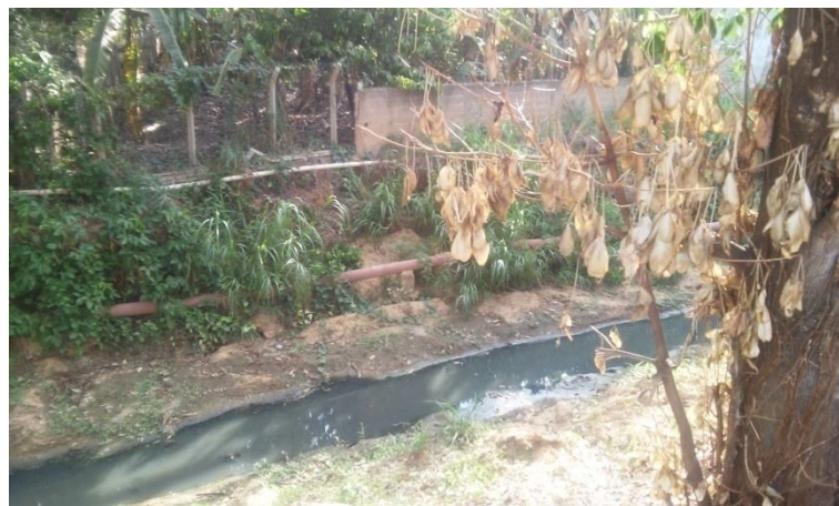
Foto 2 – Danos ao pilareti – tubulação de esgoto fora de nivelamento, devido a enchente – arquivo pessoal 07/10/2016
