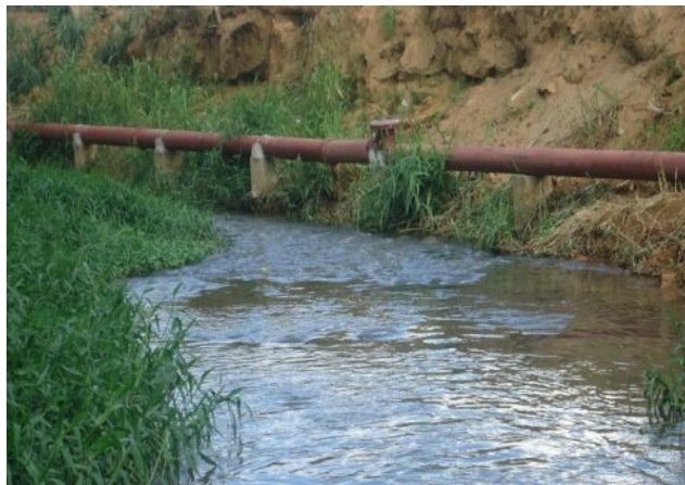
Foto 8 – Rede de coletora de esgoto sanitário, aérea, fixa em pilaretis no contrato 45/2012 - arquivo pessoal janeiro/2014
